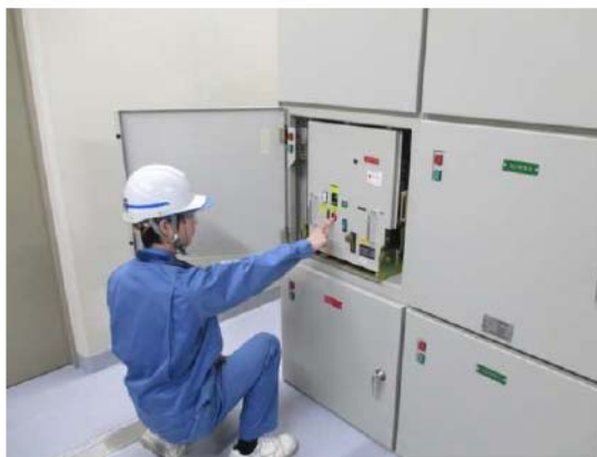
原子炉トリップ遮断器現場開放操作 (原子炉建屋 T.P. 17.8m)
