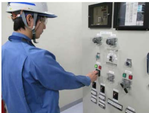
制御棒駆動装置用電源出力遮断器現場開放操作 (原子炉建屋 T.P. 17.8m)
