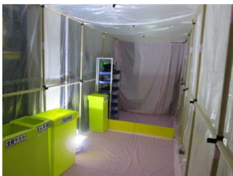
可搬型照明①
