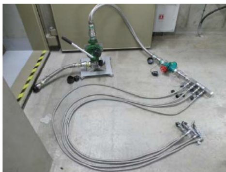
潤滑油供給器及び継手類一式
