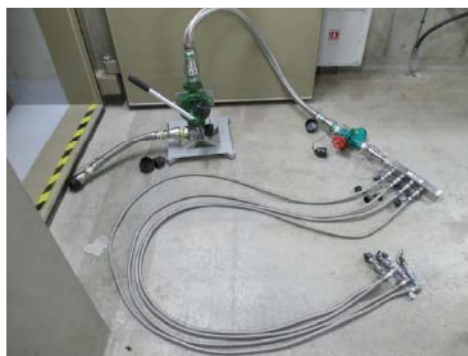
潤滑油供給器及び継手類一式 (タービン動補助給水ポンプ室に常設)
