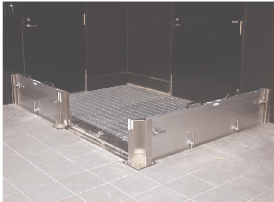
(4) 止水板サンプル写真（漏えい防止堰 No. ⑮前に設置）
