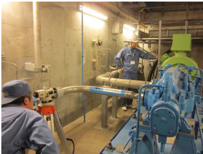
（電動補助給水ポンプの例）
