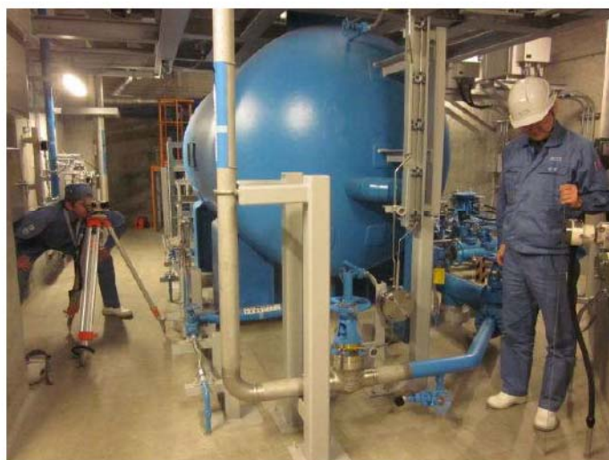
別紙 1-図 4 計装類（原子炉補機冷却水サージタンク水位）
