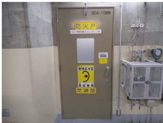
(7) B-格納容器スプレイポンプ室扉
