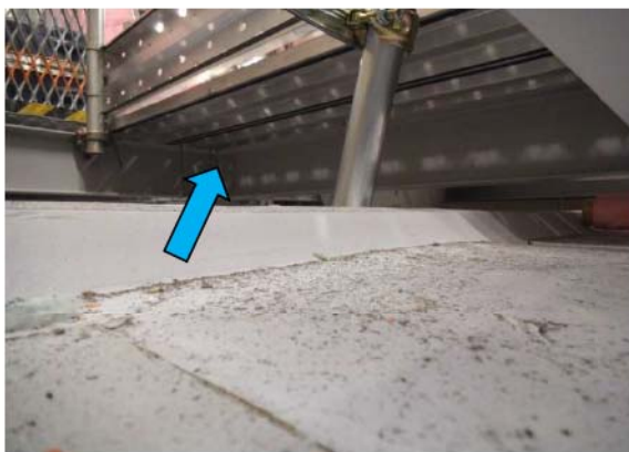
(3) B-安全補機配管室内の堰
