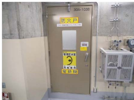
(6) A-格納容器スプレイポンプ室扉
