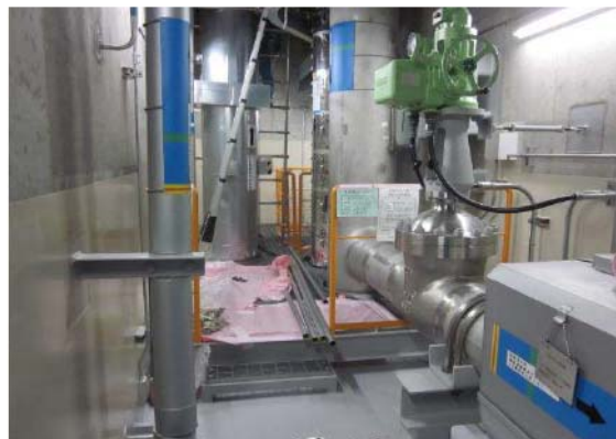
(2) B-安全補機配管室内
