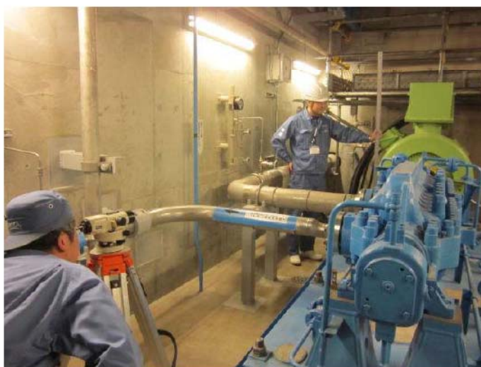
別紙 1-図 2 ポンプ類（電動補助給水ポンプ）
