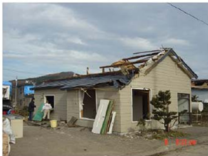
屋根全体が飛散した住宅
