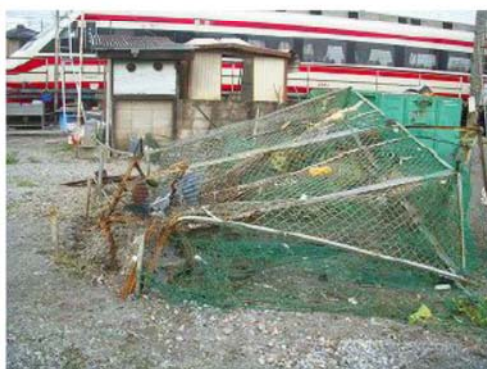
写真 20 フェンスの著しい変形
