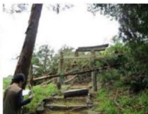
写真 3.5-16 樹木の折損と鳥居の被害
