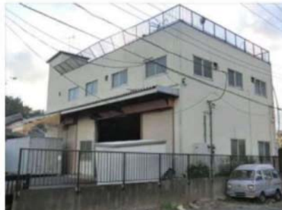
写真 5.1.14 屋上フェンスの被害
