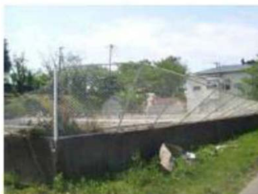
写真 3.5-10 フェンスの被害状況
