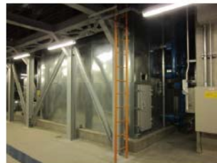
空調ユニット
