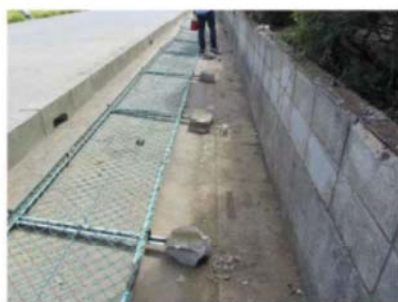
写真 4.1.9 フェンスの倒壊
