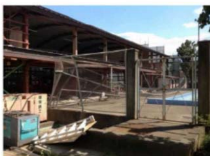
写真 5.2.19 フェンスの被害（工事中の建築物）
