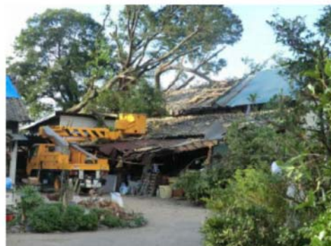
写真 5.1.13 樹木の倒壊による小屋組の被害
