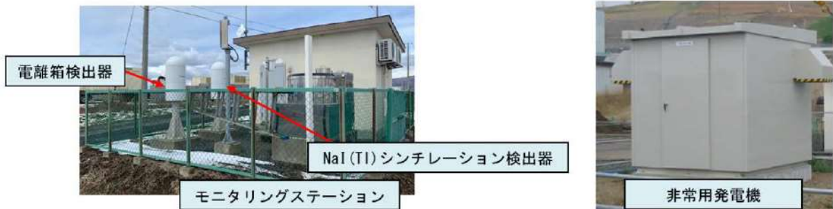
図3 モニタリングステーションの設置状況
