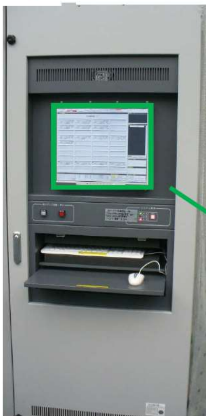
写真④ 中央制御室 総合操作盤
