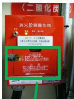
写真⑤ 消火設備操作箱
