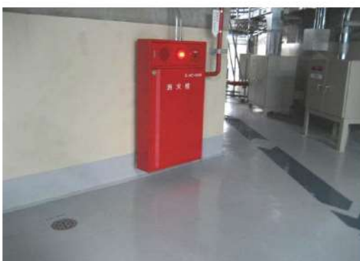
図-9 屋内消火栓
