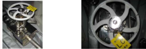
図2 弁施錠状態の例の写真
