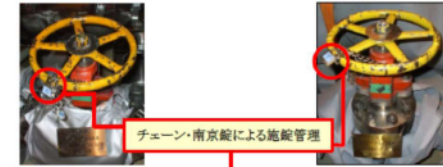
原子炉再循環系ドレンライン 【原子炉再循環ポンプ（A） 入口管第一ドレン弁（B32- F503AX）】
