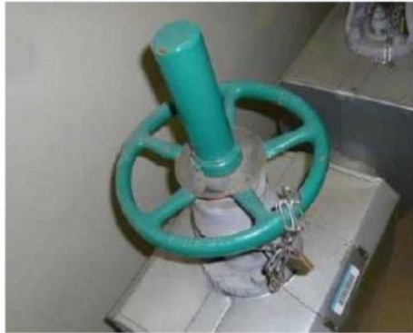
図2 弁施錠状態の例
