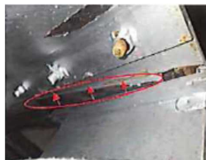
シムプレートのずれ
