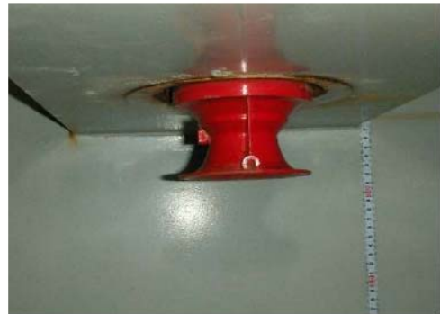
ポンプ部ベルマウス
