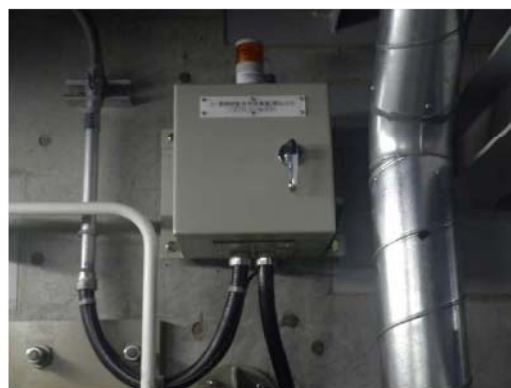
図2 現場盤（ブザー付き表示灯）
