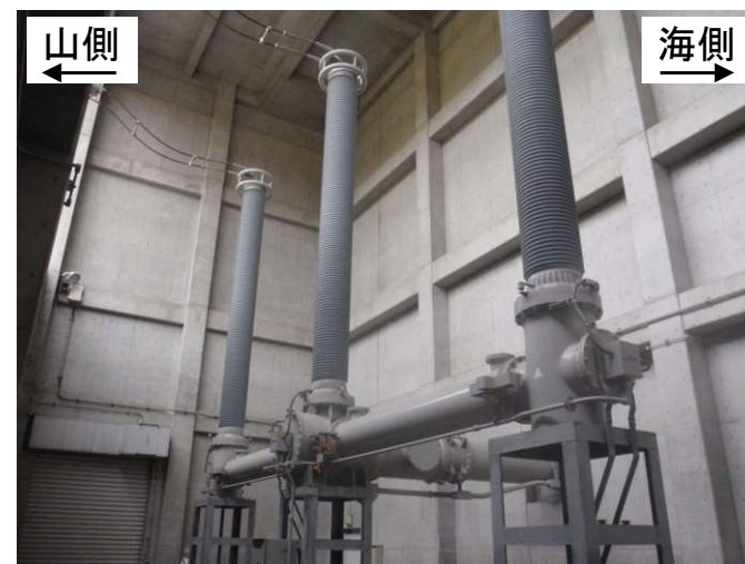
ポリマー碍管（遮風建屋内）
