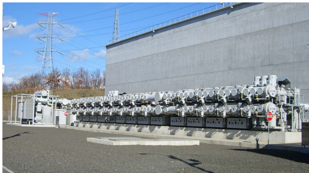
開閉所 275kVガス絶縁開閉装置
