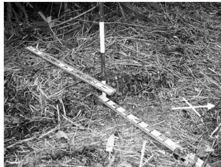
写真-1 尾根部で確認された13cmの段差 写真位置は図-4参照。
