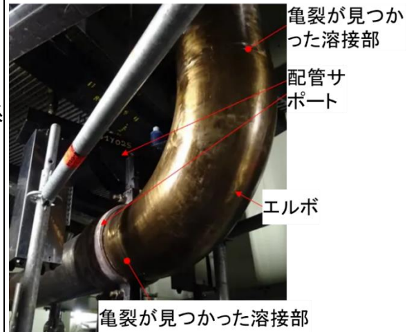
図2 亀裂が見つかった溶接部
