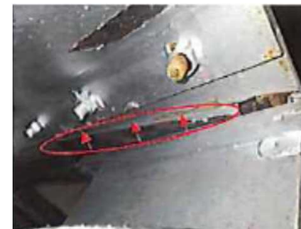
シムプレートのずれ
