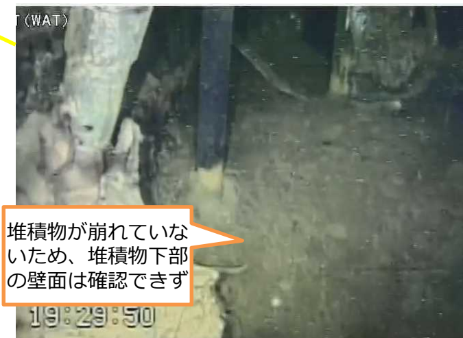
写真6. 遮へい板裏ペDESTAL壁面 (堆積物周辺)
