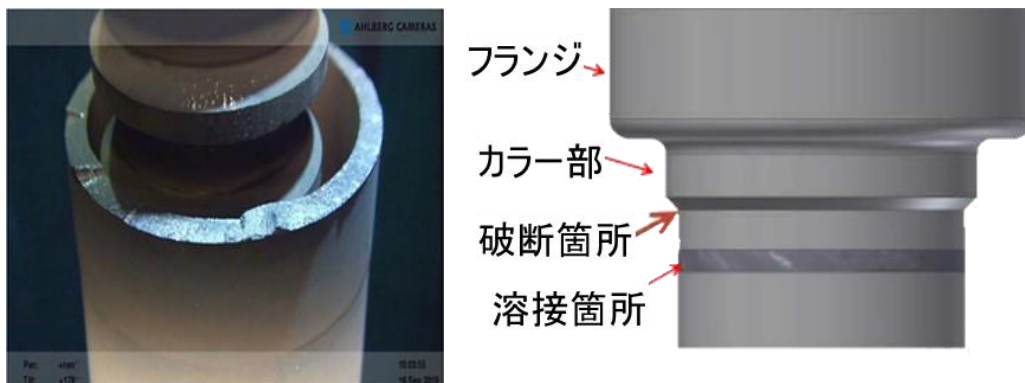
図 1 サーマルスリーブ破断箇所
