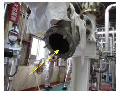
②ストレーナ内部
