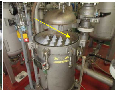
フィルタ格納容器内部
