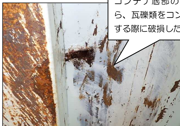
コンテナ3（補修前）
