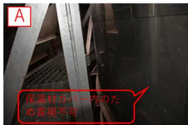
金属保温材 (生体遮蔽廻り)
