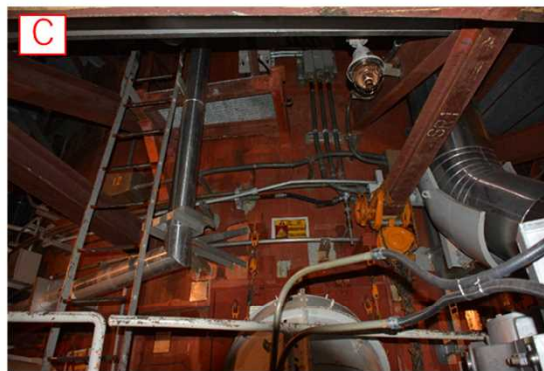
金属保温材 (再循環配管廻り)
