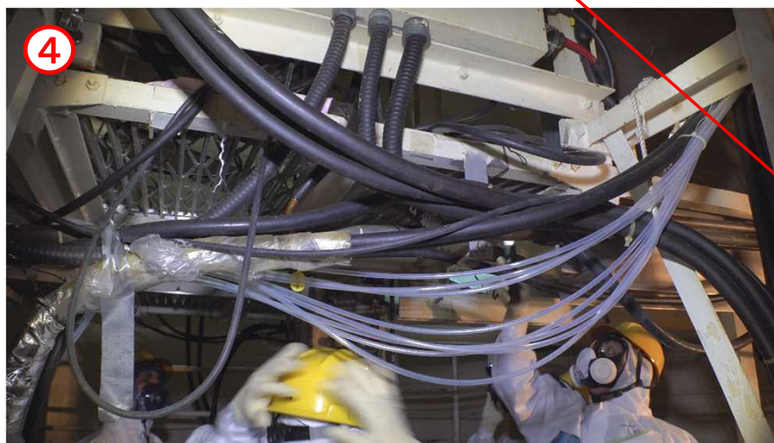
SRNM/LPRMケーブル(ペDESTアル内)
