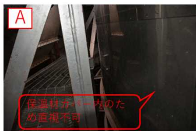
金属保温材 (生体遮蔽廻り)
