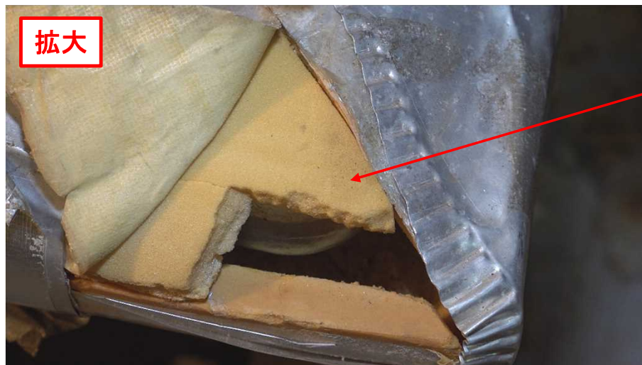
原子炉補機冷却水系配管保温材 (保温材カバー内) ウレタン保温材
