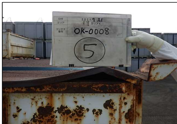
コンテナ1（補修前）
