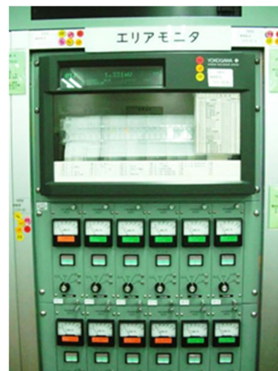
監視盤 (放射線管理室)
