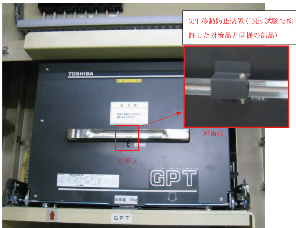
図 GPT 移動防止装置の取付対策（例）
