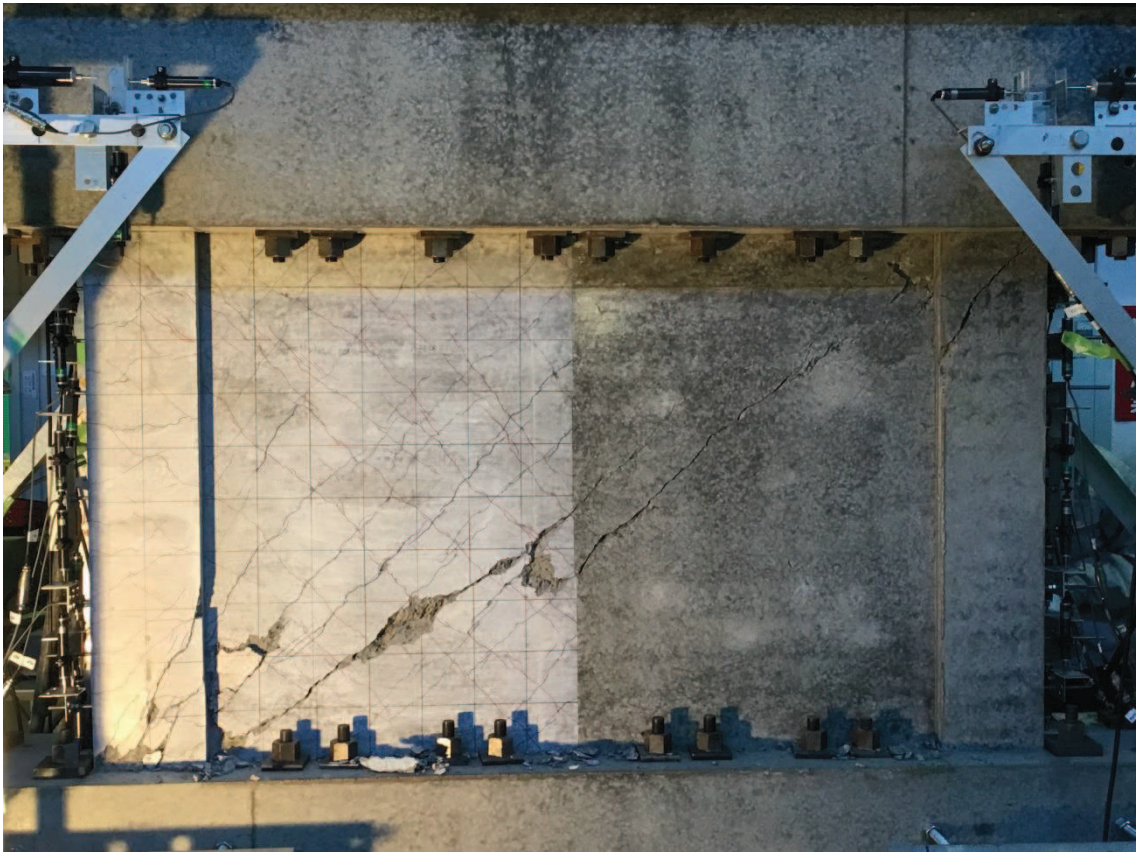
図 2-6 試験体 S-06-D0 最終破壊時写真
