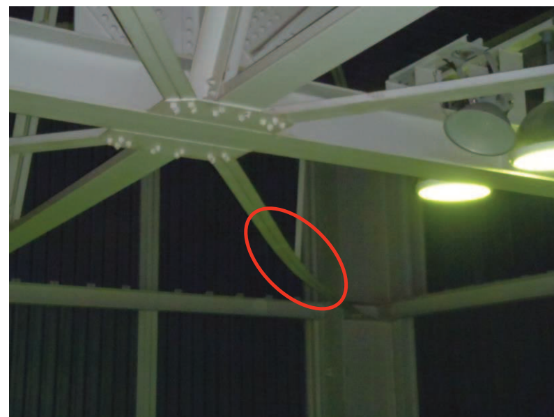
下弦水平ブレース(仮設部材) 160mm変形
