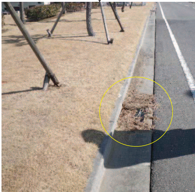
写真2 構内道路上に残留した塵芥
