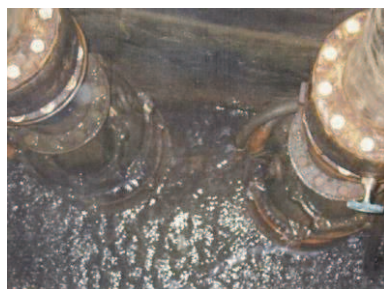
2号機揚水ポンプの例（揚水井戸⑥）
