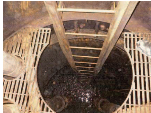
写真C 揚水井戸⑦(下段部) 2017/3/16撮影
