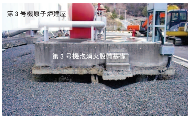
写真⑥ 沈下発生状況
