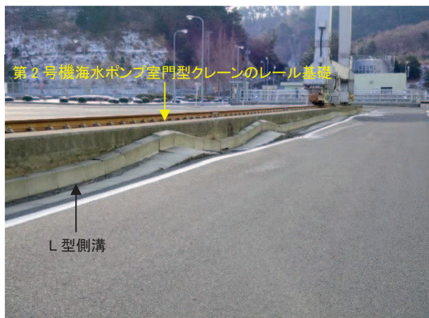
写真㉔ 沈下発生状況
