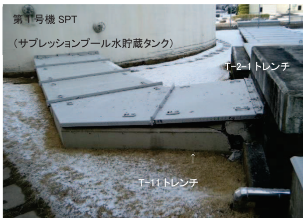
写真㉔ 沈下発生状況
