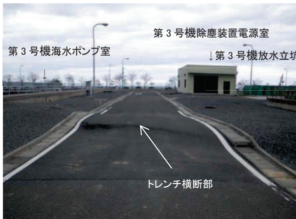
写真㉓ 沈下発生状況
