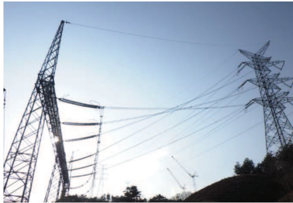
図 10.2.3-4 第 3 号機開閉所引留鉄構の架線状況
