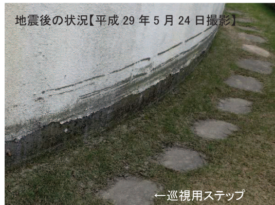
図 7.2-4 2011 年東北地方太平洋沖地震における沈下発生状況 (4/5)
