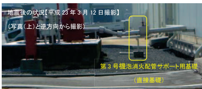
写真⑥' 沈下発生状況
