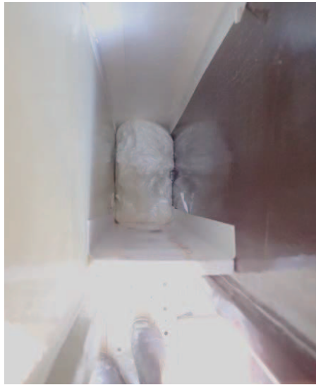
図3 目地内部でのウレタンの発泡状況
