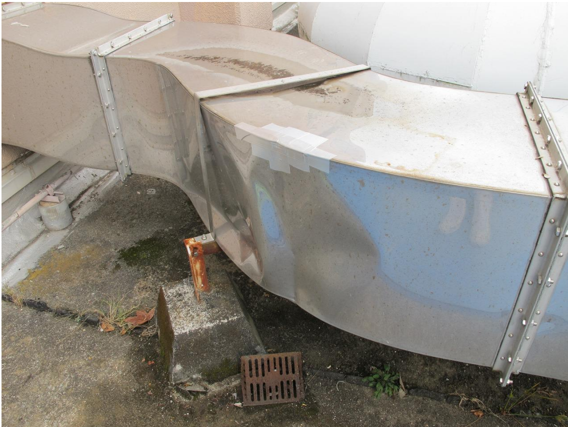
写真② 排気用ダクトの亀裂（全景）
