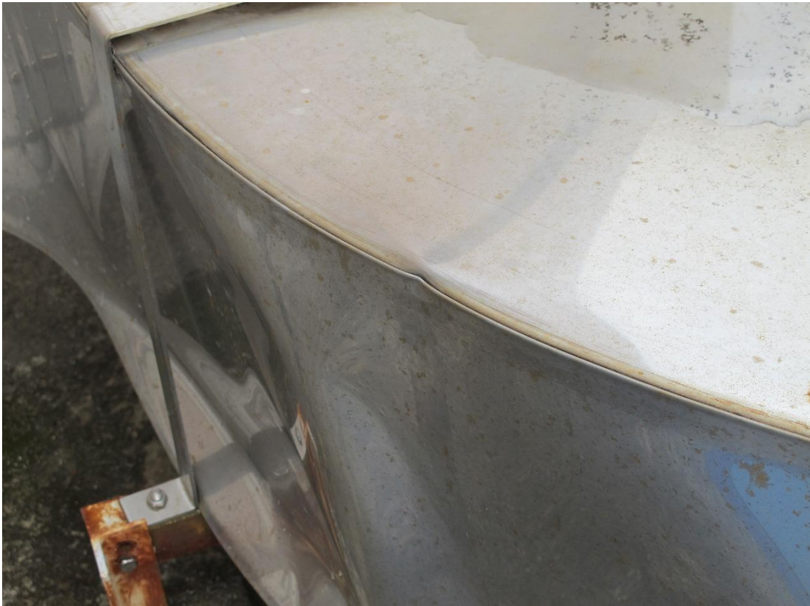
写真① 排気用ダクトの亀裂
