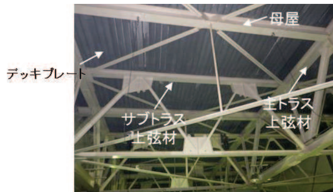
図 5.6-6 原子炉建屋原子炉棟天井の状況
