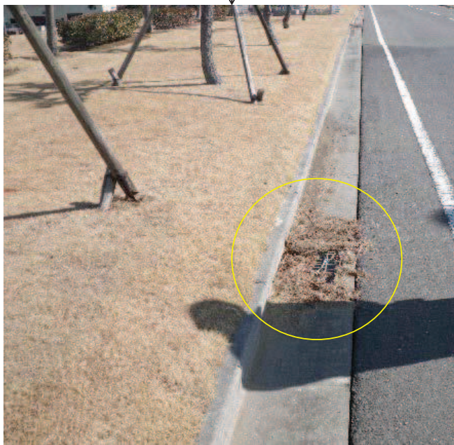
写真2 構内道路上に残留した塵芥
