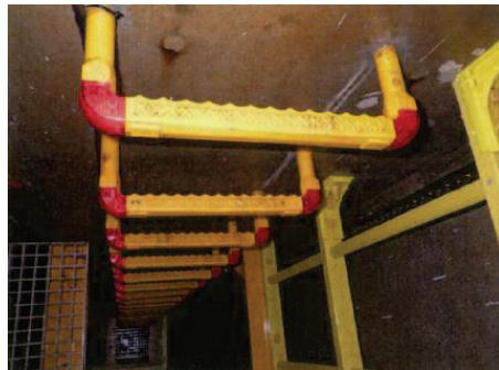
写真C 揚水井戸⑤(中段部) 2017/3/17撮影
