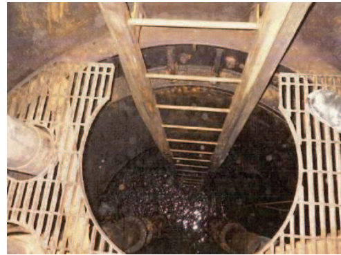
写真C 揚水井戸⑦(下段部) 2017/3/16撮影
