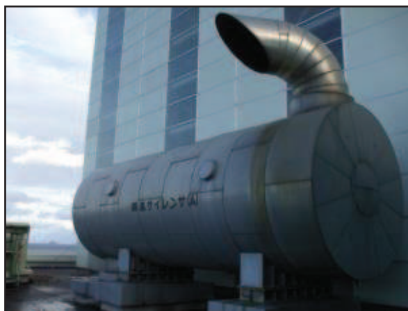
図 2.3-8 ディーゼル発電機 排気管
