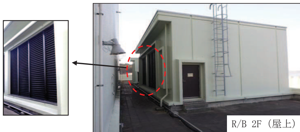
図 2.3-2 原子炉補機（A）室換気空調系の外気取入口
