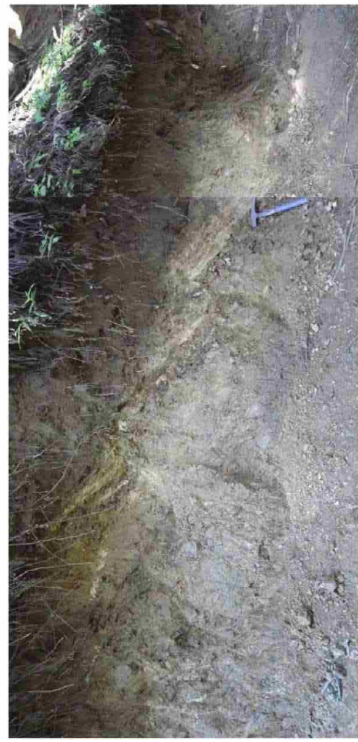
断層部の全景
