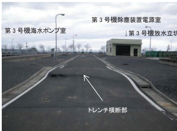
写真㉓ 沈下発生状況
