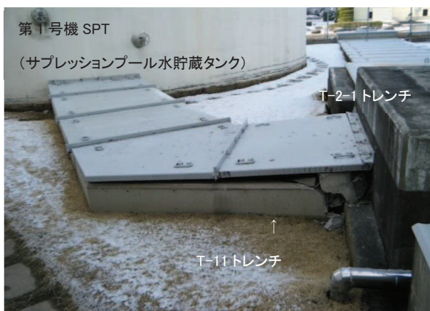
写真㊦ 沈下発生状況
