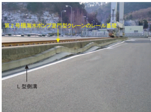
写真㉔ 沈下発生状況
