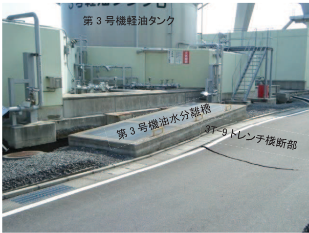
写真① 沈下発生状況
