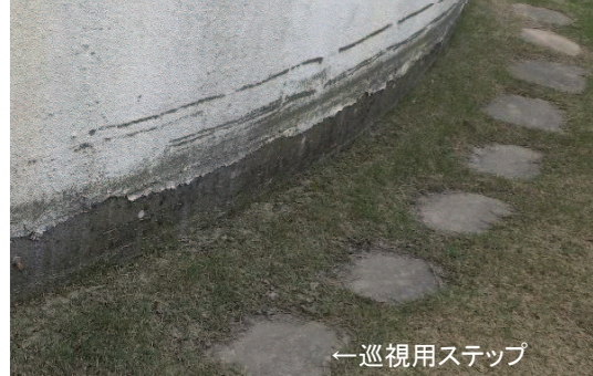
図 7.2-4 2011 年東北地方太平洋沖地震における沈下発生状況 (4/5)
