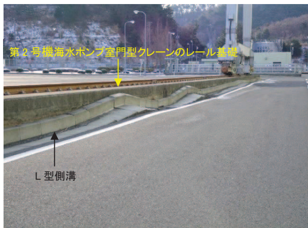
写真㉔ 沈下発生状況
