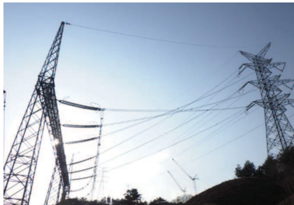
図 10.2.3-4 第 3 号機開閉所引留鉄構の架線状況
