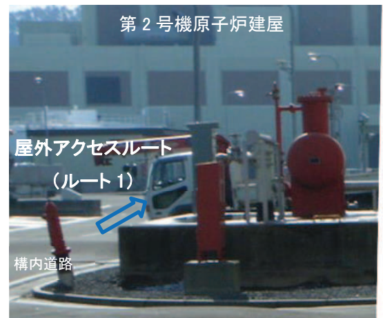
写真 C:地震後の状況【平成 23 年 3 月 12 日撮影】
