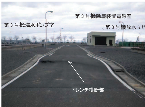
写真㉓ 沈下発生状況
