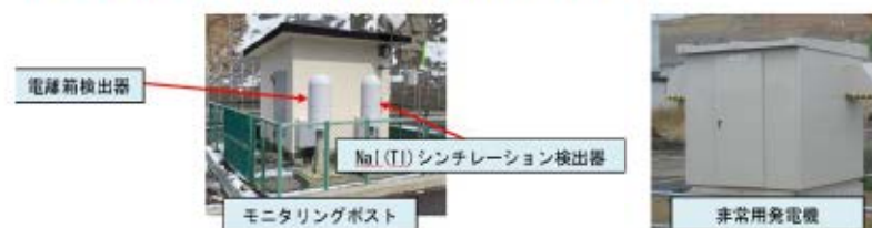
図3 □モニタリングポストの設置状況
