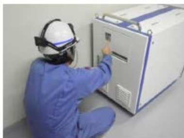
可搬型バッテリー 原子炉補助建屋（T.P.17.8m）
