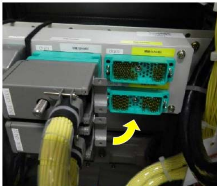
(1次系制御監視盤内 切替器)
