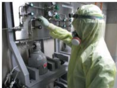
窒素供給操作(バルブパネル操作) (原子炉補助建屋 T.P. 40.3m)
