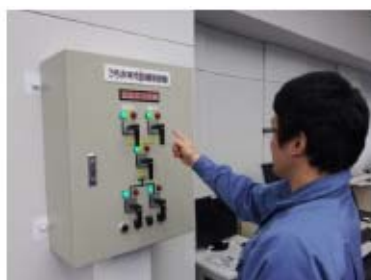
3号非常用受電設備遮断器操作 （中央制御室） （原子炉補助建屋T. P. 17. 8m）
