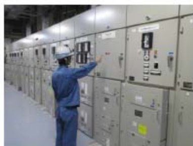
M/C電源確認 (安全補機開閉器室) (原子炉補助建屋T. P. 10. 3m)
