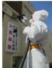
可搬型代替電源車の給油口に 給油ガン接続 (可搬型代替電源車) (屋外 T.P. 31m)
