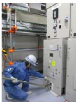
代替非常用発電機受電遮断器操作 (安全補機開閉器室) (原子炉補助建屋T. P. 10. 3m)
