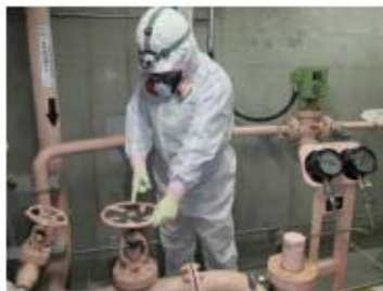
燃料汲み上げ系統構成 (ディーゼル発電機室) (原子炉建屋T.P. 6.2m)
