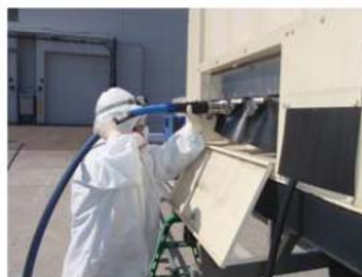
高圧ケーブル接続 (屋外T. P. 31m)
