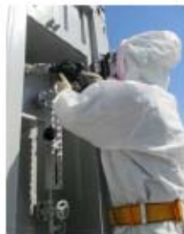
代替非常用発電機の給油口に 給油ガン接続 (代替非常用発電機) (屋外 T.P. 31m)
