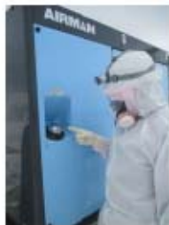
緊急時対策所用発電機 給油口 (緊急時対策所用発電機) (緊急時対策所エリア T.P. 31m)
