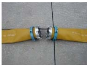
可搬型ホース(150A)接続口
