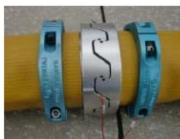
可搬型ホース(150A)接続後
