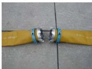
可搬型ホース(150A)接続口
