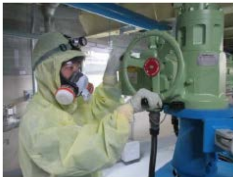
1 次冷却材ポンプ封水ライン隔離弁 閉止操作 (原子炉建屋 T.P. 21. 2m)
