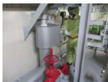
原子炉への注水ライン 系統構成 (運転員（現場）①) (原子炉補助建屋 T.P. 14.5m)
