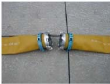
可搬型ホース(150A)接続口
