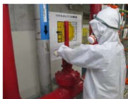
消火水注水系統構成 （運転員（現場）②） （原子炉建屋 T.P. 17. 8m）
