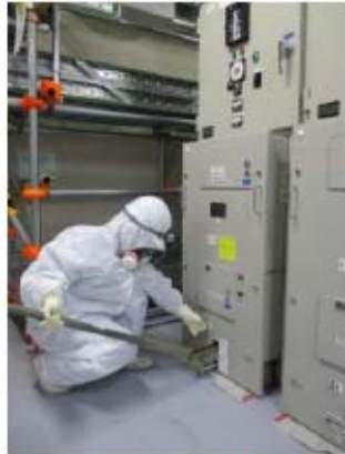
受電遮断器操作 (原子炉補助建屋 T. P. 10. 3m)
