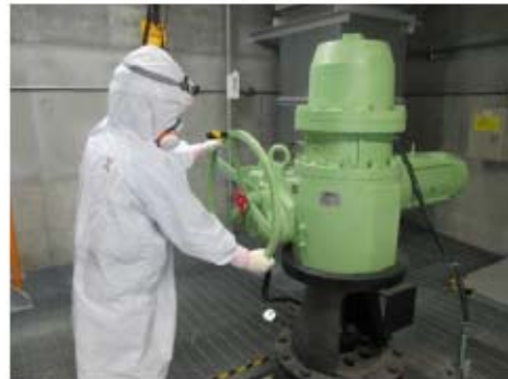
主給水隔離弁閉止操作 (原子炉建屋 T. P. 34. 4m)
