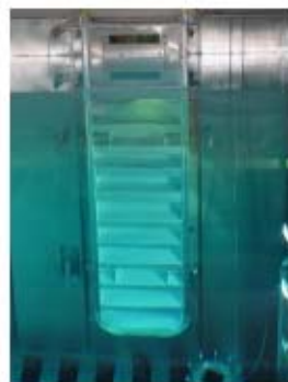
ゲートの設置状況
