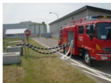
可搬型大型送水ポンプ車の設置 代替給水ビットへの吸管挿入 (屋外 T. P. 31m) (作業風景は類似作業)
