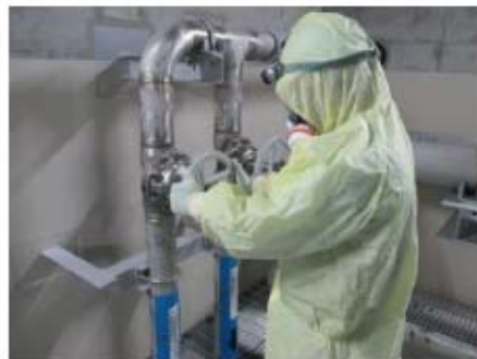
燃料取替用水ポンプによる注水系統構成 (原子炉建屋 T.P. 10. 3m)
