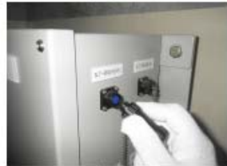
ケーブル接続 BOX
