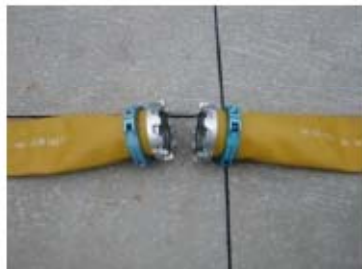
可搬型ホース (150A) 接続口
