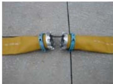
可搬型ホース (150A) 接続口
