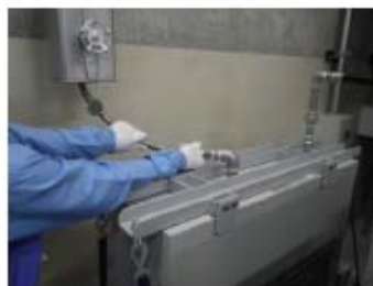
空冷配管との接続
