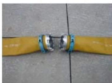
可搬型ホース(150A)接続口
