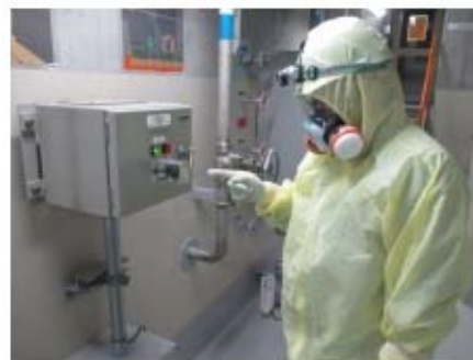
1次系補給水ポンプによる注水 (原子炉補助建屋 T.P. 17.8m)
