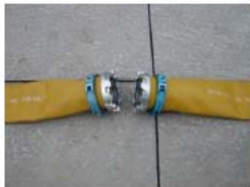
可搬型ホース(150A)接続口
