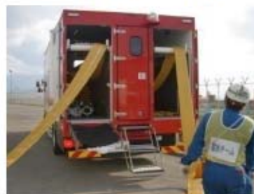
ホース延長・回収車による 可搬型ホース敷設 (屋外 T. P. 31m)
