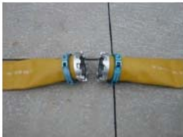
可搬型ホース (150A) 接続口
