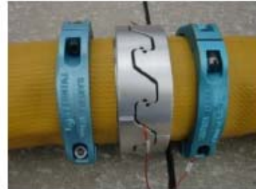
可搬型ホース(150A)接続後
