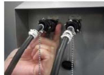
検出器用ケーブル接続
