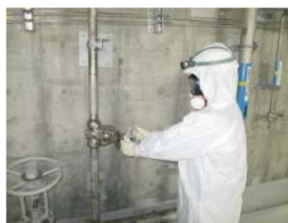
格納容器へのスプレイライン系統構成 （運転員（現場）②） （原子炉建屋 T.P. 10. 3m）
