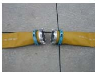
可搬型ホース (150A) 接続口
