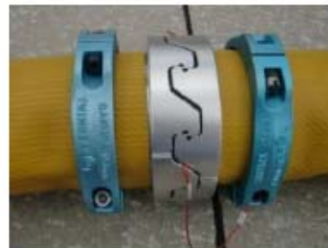
可搬型ホース (150A) 接続後
