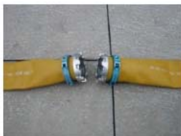
可搬型ホース(150A)接続口
